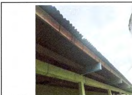
FOTO 4: Sustrucción de canal de metal
